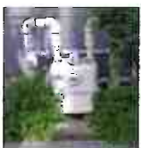
(ガスメーター)
