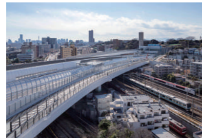
横浜北線鉄道(JR,京急)交差点新設工事
