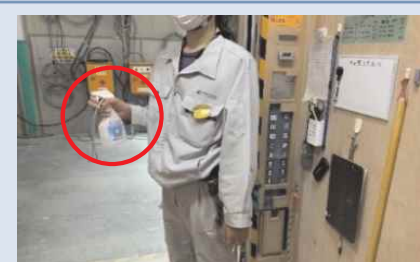
EVの操作盤等の消毒を徹底
