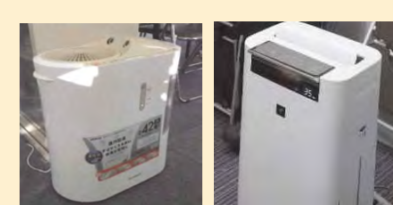
空気清浄機を設置
